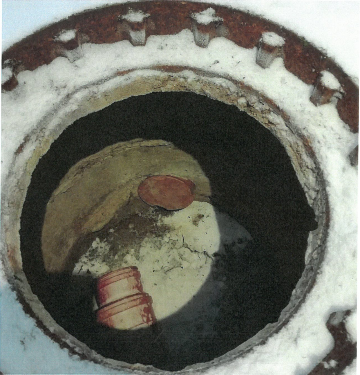
Kuva 5. Ylivuotokaivo johon tarkastuskaivosta tulee putki kuvassa alempana ja Kemijärven vesi ja lämpö Oy:n tulppaama ylivuoto putki ylempänä, josta viemäri oli päässyt vuotamaan ojaan (9.1.2023). Kaivossa on maapohja Kemijärven vesi ja lämpö Oy:n mukaan.
